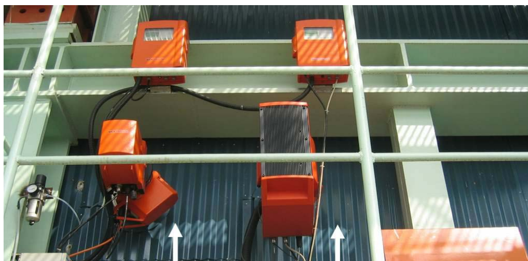
Obrázek 1 Typická instalace měření In-situ
