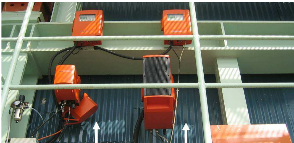
Obrázek 2 Typická instalace měření In-situ
